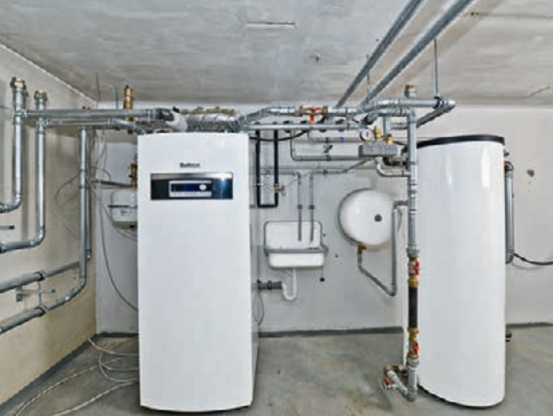
Mit Erdwärme betriebene Wärmepumpe für die Beheizung und Warmwasserbereitung
