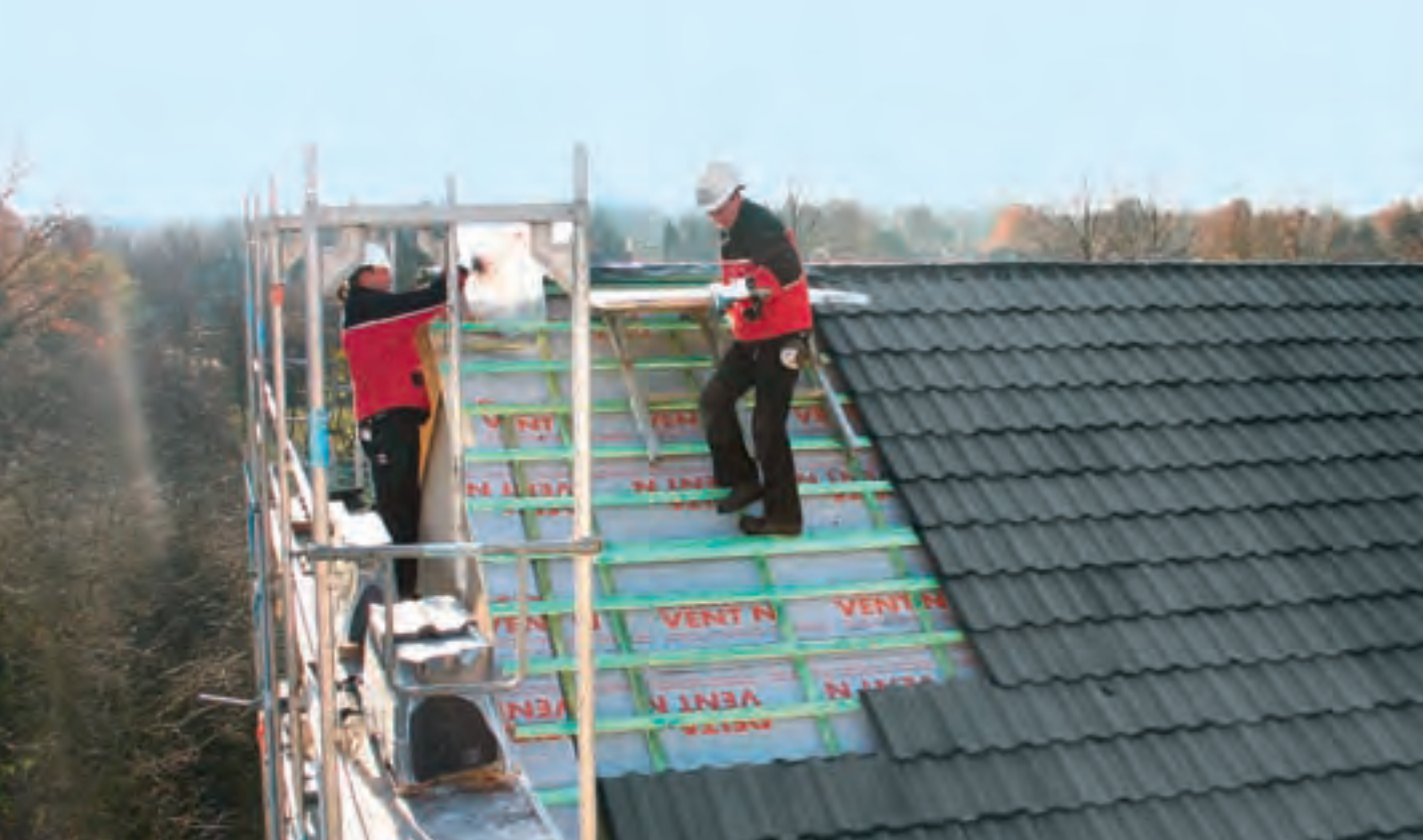
Climalife-Ziegel machen Luftschadstoffen den Garaus: Neue Dächer gibts bei VIVAWEST nicht mehr ohne
